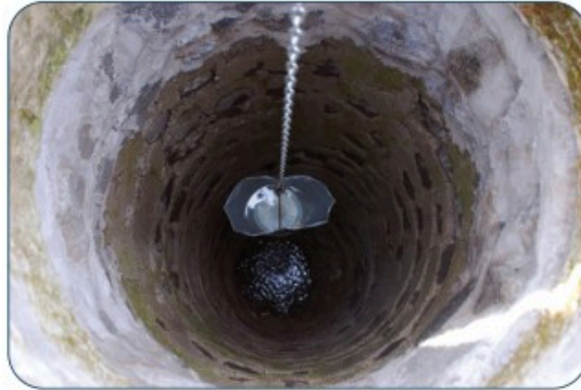
شكل 8-3 آبار المياه الجوفية
