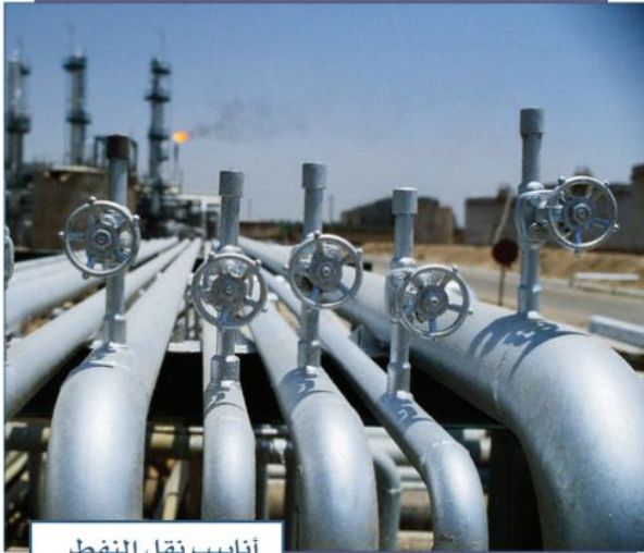
أنابيب نقل النفط
