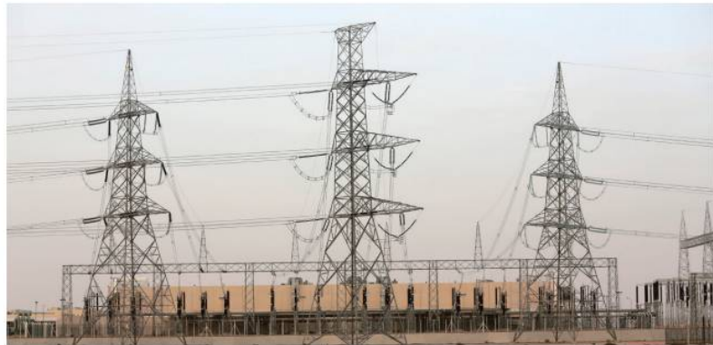
محطة سدير لتحويل الكهرباء
