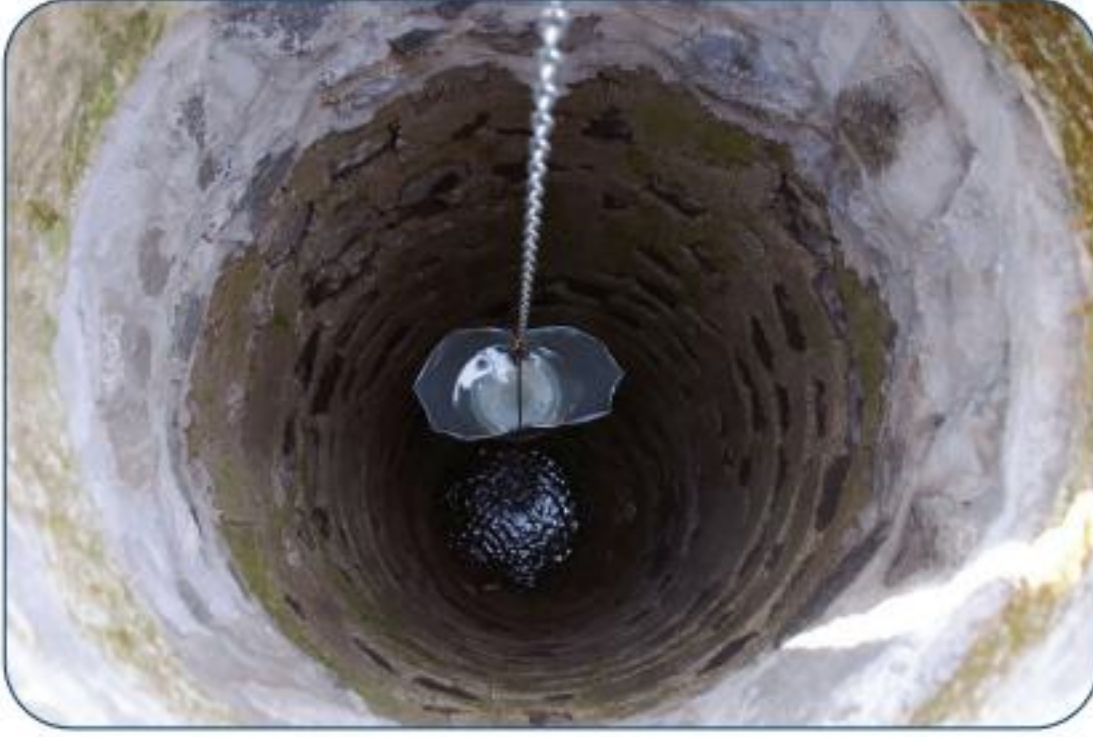
شكل 8-3 آبار المياه الجوفية
